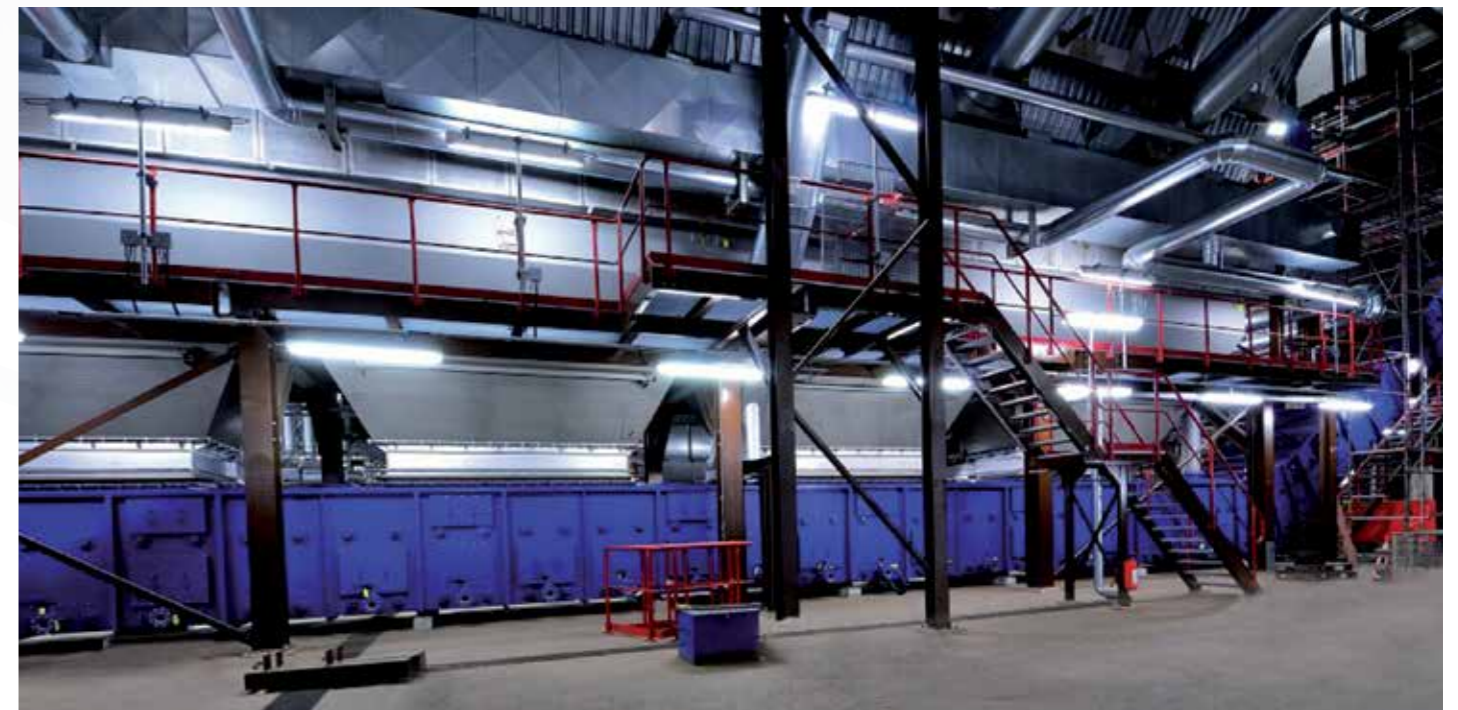
▶ DRYCON™-System im Einsatz im Steinkohlekraftwerk Lünen (Deutschland)
