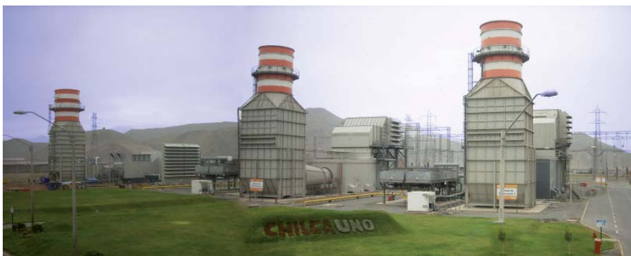
Das Kraftwerk Chilca Uno mit den bisherigen Abgasschächten
