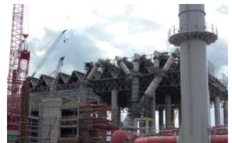
Kraftwerk Medupi hat den weltgrößten luftgekühlten Kondensator
