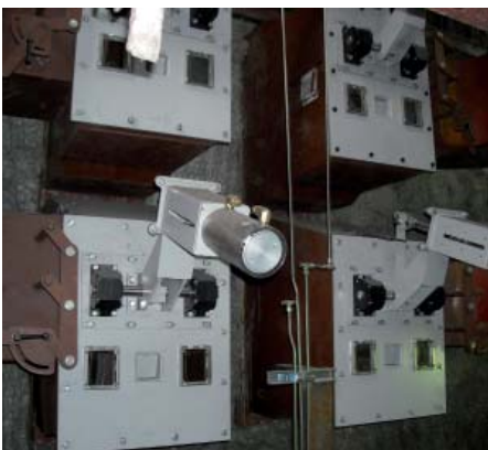
An der Kesselwand eingebaute Air Ports
